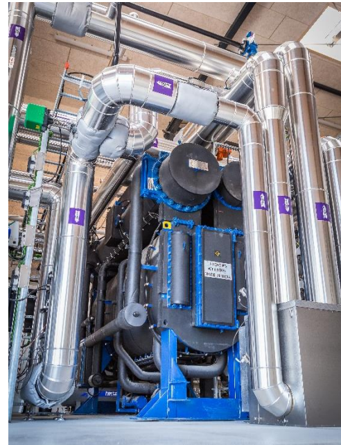
Langå Varmeværk A.m.b.a.
