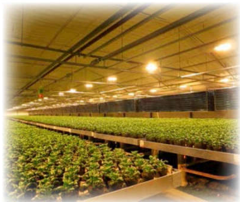
Solfangerne er monteret som et bevægeligt system. Ved hjælp af et wiretræk kan de køres ud i siden af væksthuset, f.eks. når der skal arbejdes med planterne, eller planterne har brug for lys.
